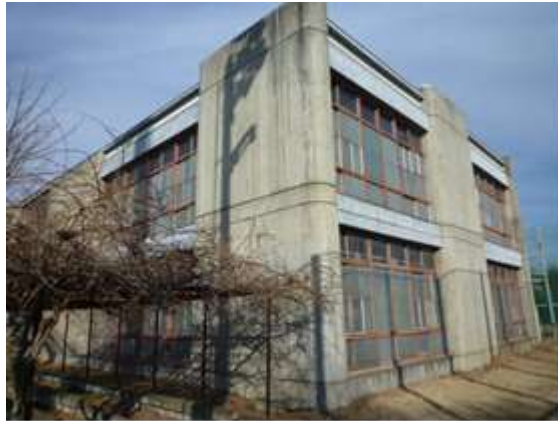
武道場 (建物の老朽化が著しい)
