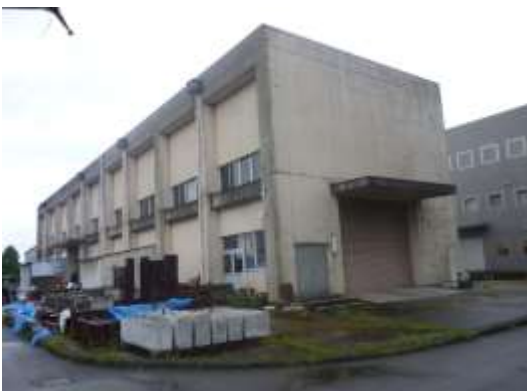
建設実験棟 (建物の老朽化が著しい)
