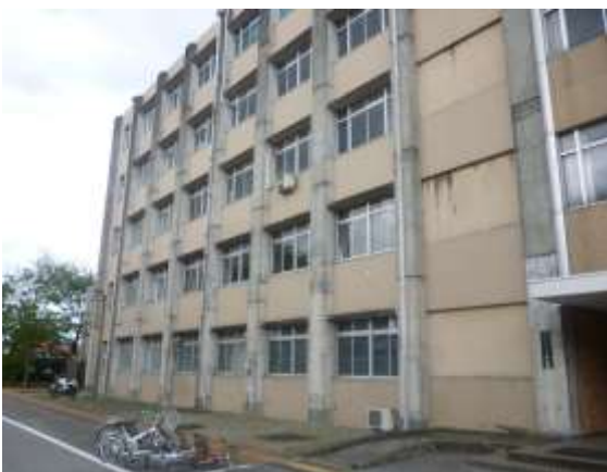
峰町6号館 (建物の老朽化が著しい)
