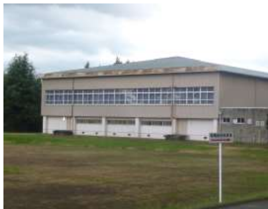
陽東体育館 (建物の老朽化が著しい)
